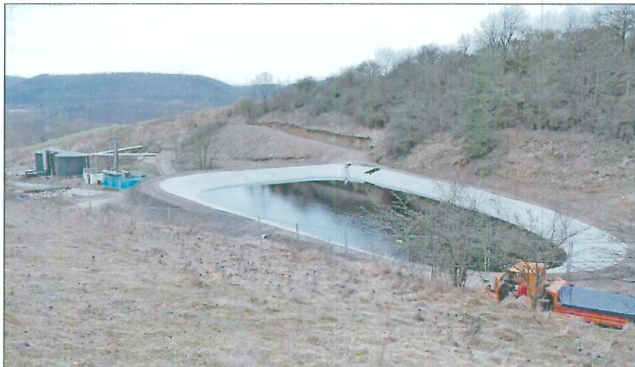
Das neue Speicherbecken für Sickerwasser am Fuß der Meininger Deponie kann 1800 Kubikmeter aufnehmen. Unterhalb liegen die bisherigen Speicher mit einem Fassungsvermögen von 1300 Kubikmetern sowie die kleine Kläranlage. Sie kann binnen 24 Stunden 50 Kubikmeter Wasser reinigen. Foto: Ralph W. Meyer
