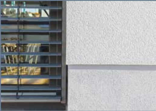
Diese interessante Oberflächenstruktur entsteht dadurch, dass Körner aus dem geglätteten Einlagen-Kratzputz Knauf Presto One mit einem Nagelbrett ausgekratzt wurden.
