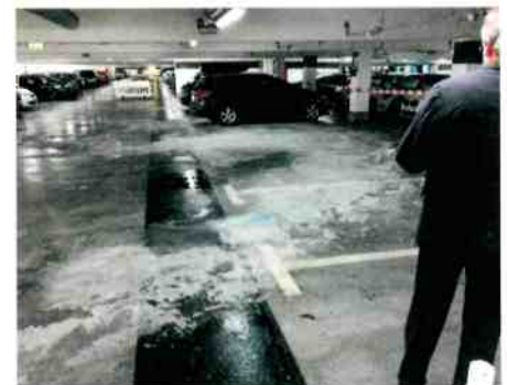
Bild 3: Eisschollenbildung auf der Bodenplatte
