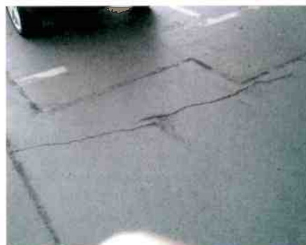
Bild 2: Rissbildung in einer OS11a-Beschichtung
