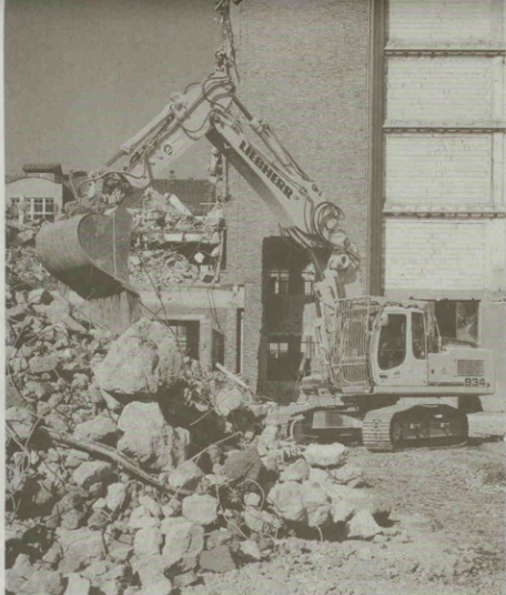
Auf dem Gelände des ehemaligen SKW-Werkes I sind derzeit zwei Liebherr-Hydraulikbagger des neuen Typs R 934 C beim Rückbau im Einsatz. Foto: Liebherr
