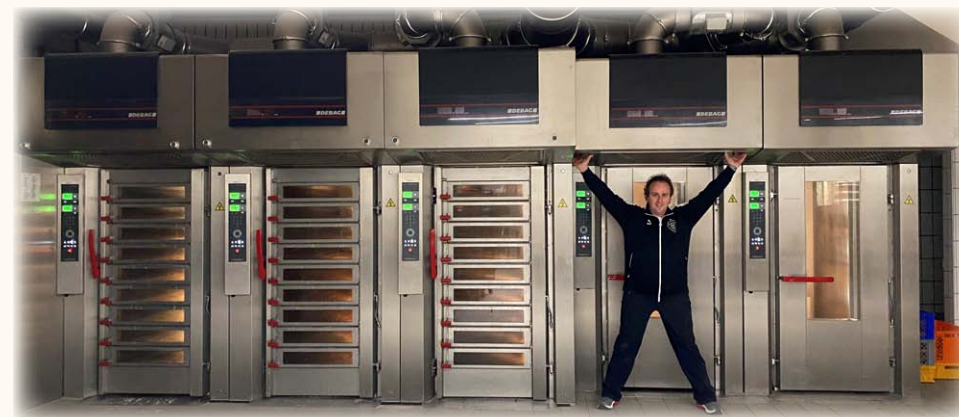
Daniel Link in der Backstube vor den neuen Backöfen, welche im Jahr 2021 eingebaut wurden. Rund 8% Energie können seither bei gleichem Backergebnis eingespart werden.
