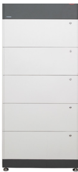
Batteriespeicher (Foto Lichtex.de)
