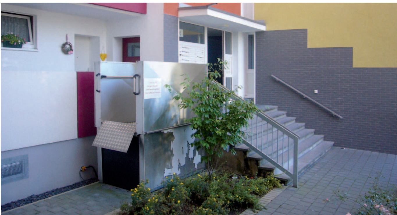
Hublift zur Überwindung der Eingangstreppe in Köln
