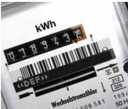
Strom: mindestens 2 x pro Jahr kontrollieren, ggf. Unterzähler einbauen.
