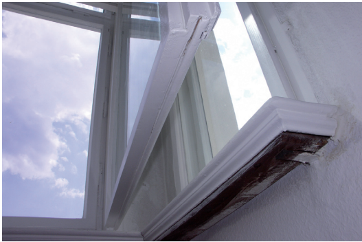
Abb. A 7.3: Nicht einseh- bare Bereiche: Unterseiten Fenster/Fensterbank
