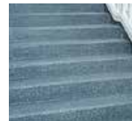
9. Die Versiegelung Triflex Cryl Finish 205 auftragen und Triflex Micro Chips einblasen, fertig.
