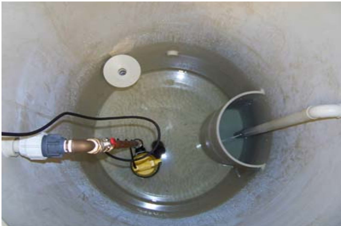
Vorlage Emulsion mit Zuführpumpe und Ölseparation
