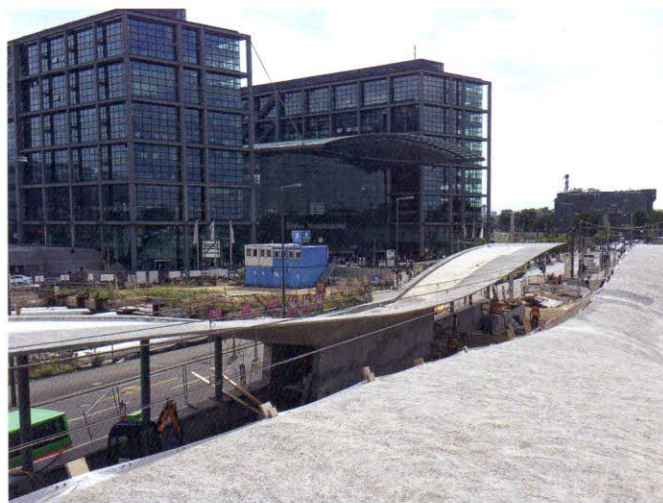
Bild 3. Das Dach auf der Bahnhofsseite: Der Beton ist geschliffen und für die Grundierung vorbereitet
