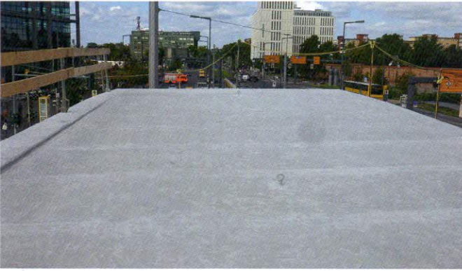
Bild 4. Das Dach auf der Bahnhofsseite mit der fertigen Abdichtung – es fehlt noch das Topsiegel
