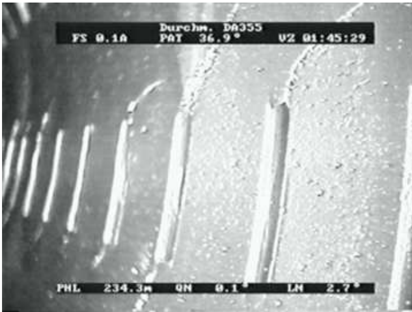
Abb. 3: Rissbildung in Drainagerohrschlitzungen
