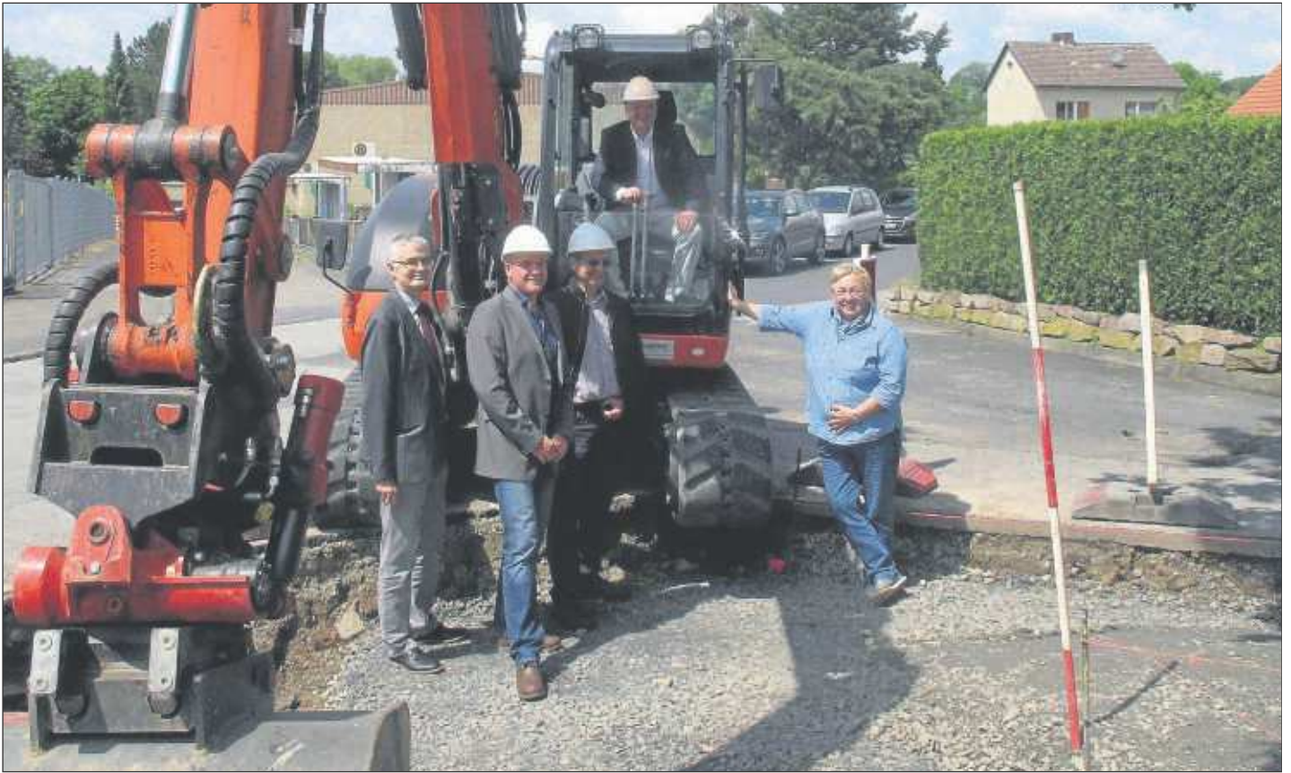
Endlich beginnen die Bauarbeiten: Ralf Franke (Landkreis Kassel), Klaus Schröder (Geschäftsführer SIG-Hessen Ingenieure), Herbert Rössel (ehemaliger Bürgermeister), Bürgermeister Jörg Schützeberg und Christa Oehler (ehrenamtliche Kreisbeigeordnete) feiern zusammen mit vielen Gästen den Spatenstich.
