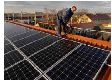
Wie hier auf dem Dach der Sporthalle der Frankenger Erich-Viehweg-Mittelschule könnten schon bald auf weiteren Flächen Fotovoltaikanlagen entstehen. Ivo Vogel von der Burgstädter Firma Elektro-Fuchs hatte das Sonnenkraftwerk damals mit montiert.
